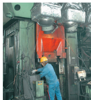
蓄熱式システムに切り替えられた 作業場のスポット空調設備
