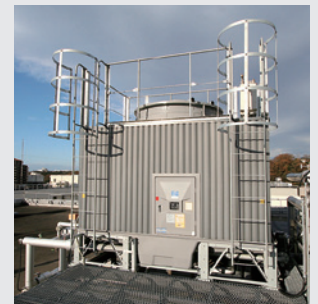
新たに設置したクーリングタワー
