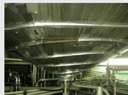
タンク下部に巻かれた 自己制御型ヒーター
