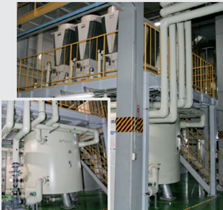
負荷の変動対策用 温水クッションタンク
