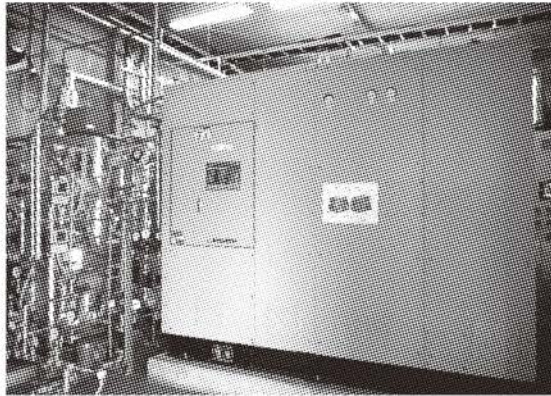
導入した三菱重工業製の熱回収型 熱水ヒートポンプETW-S
