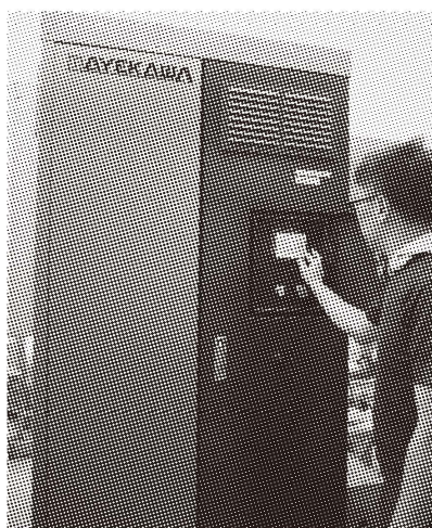
省エネ対策として採用したエレクトロヒートシステム
