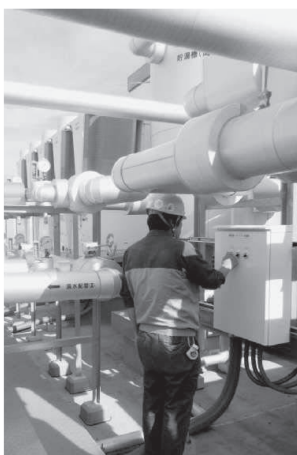
P3工場に設置した2系統12基の循環加温ヒートポンプ
