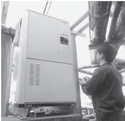
岡山工場に導入したヒートポンプ。前川製作所の製品を採用した
