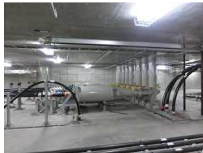
写真 3-220 kV の引込・接続
