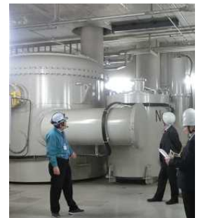
写真 4-変圧器のガスマン管
