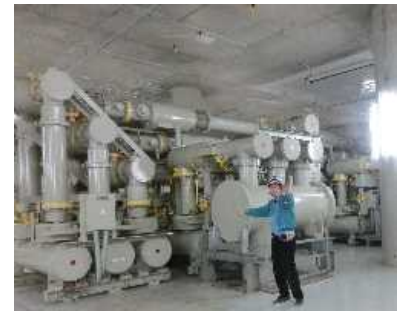
写真 2-220 kV ガス絶縁開閉器
