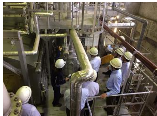
写真2 見学風景/熱交換器付近
