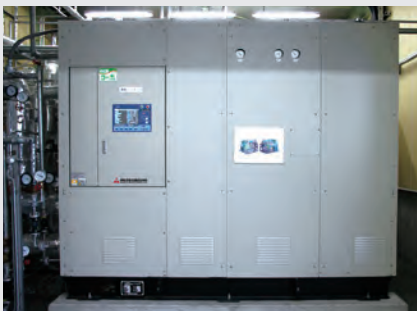
排熱回収型ヒートポンプ
