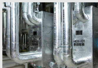
熱供給熱交換器(左)と熱回収熱交換器(右)
