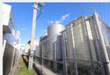
地下水のろ過設備 (地下水は工場内の用水としてだけでなく、近隣地域の非常用水源としての役割も担う)
