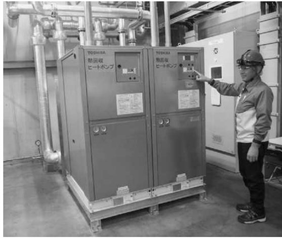
丸亀第五工場に導入した熱回収ヒートポンプ
