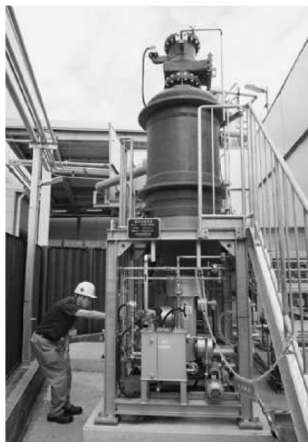
ヒートポンプ式蒸発濃縮装置
