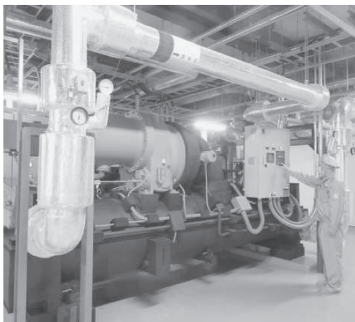
持田製薬工場で更新されたターボ冷凍機
