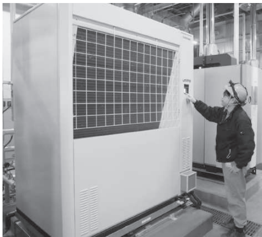
導入したヒートポンプ
