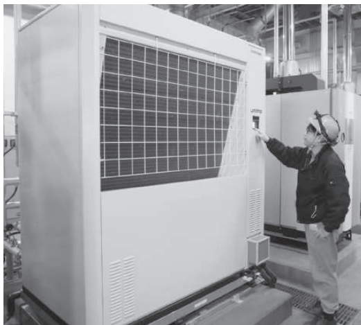
導入したヒートポンプ
